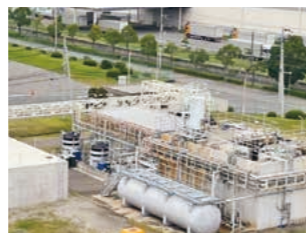
赤穂工場 排水処理施設
